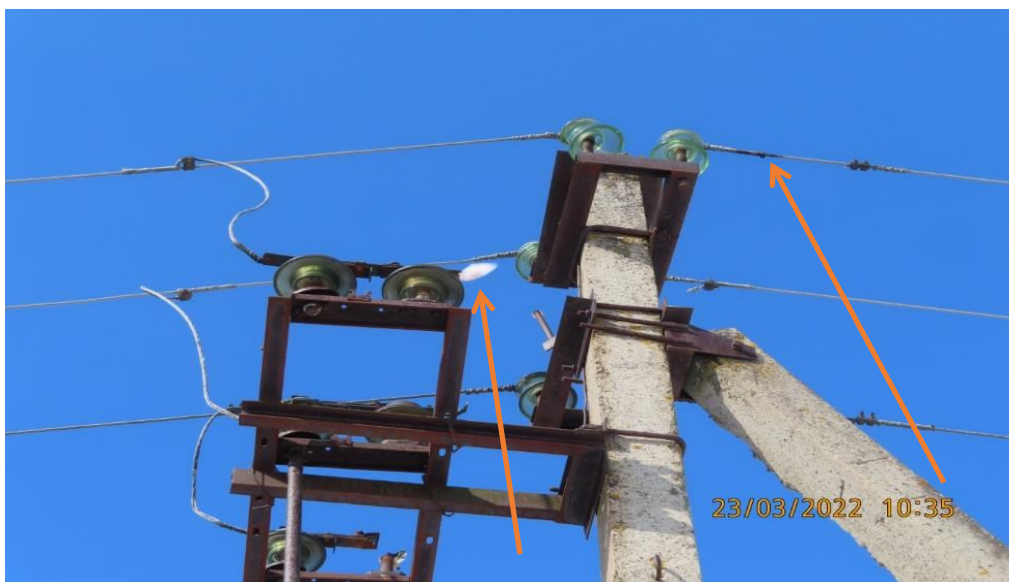
Фото опоры № 5-2 с ЛР-10 кВ (стрелками обозначены места прикосновения пострадавшего, белое пятно на среднем проводе - кусок синтепона от куртки)
